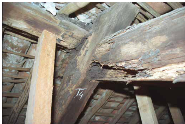
Fig.8 Detalhe do encontro das asnas da tesoura da cobertura da Igreja de N. Sª. das Fronteiras. Foto da autora. Setembro/2002.
