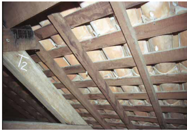
Fig.5 vista parcial da estrutura secundária da cobertura da Igreja de N.Sª. da Conceição da Congregação Mariana/Recife (caibro serrado e ripão). Foto da autora. Outubro/2002
