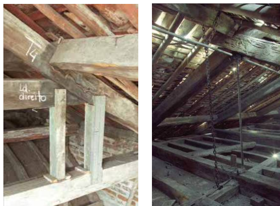
Fig. 9 e 10 Desvão da capela-mor da Igreja de N.Sª. da Boa Vista/Recife e fixação inadequada do forro à cumeeira através de uma corrente entre duas tesouras da nave da Igreja da Matriz de Santo Antônio/Recife. Fotos da autora. Setembro/2000.
